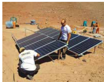
Pablo Estevez y Toni Elschner Instalando un Sistema Fotovoltaico en la III Region
